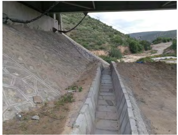
桥梁排水系统
