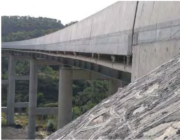
桥面径流收集管道
