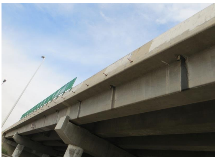
桥面设置的排水系统
