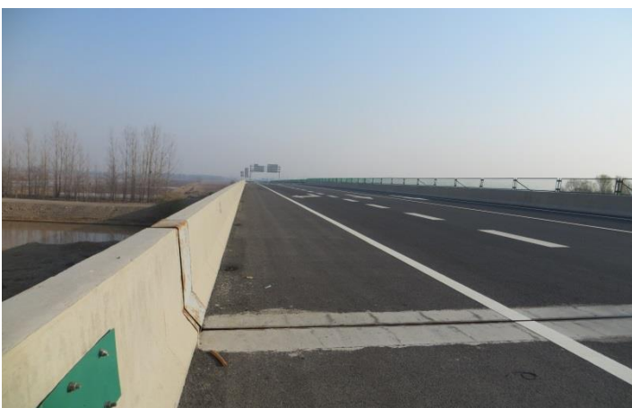
桥梁设置防撞防护栏
