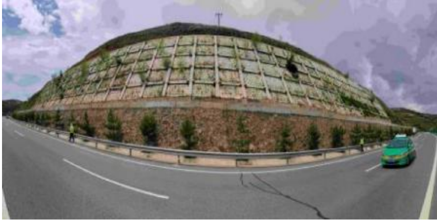
图 24 S60 固西高速 K31+500 段高边坡三级平台变形破坏情况现场
