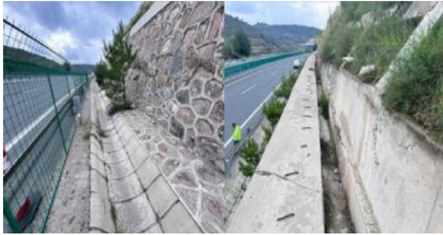
图 25 S60 固西高速 K31+500 段高边坡三级平台变形破坏情况现场照片
