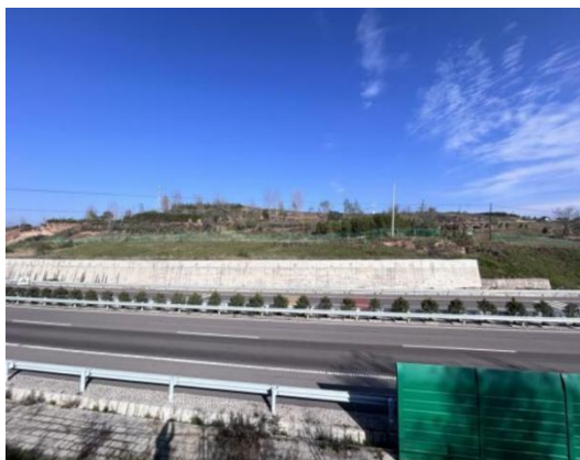
图 27 S25 泾华高速 K41+700 段滑坡现状
